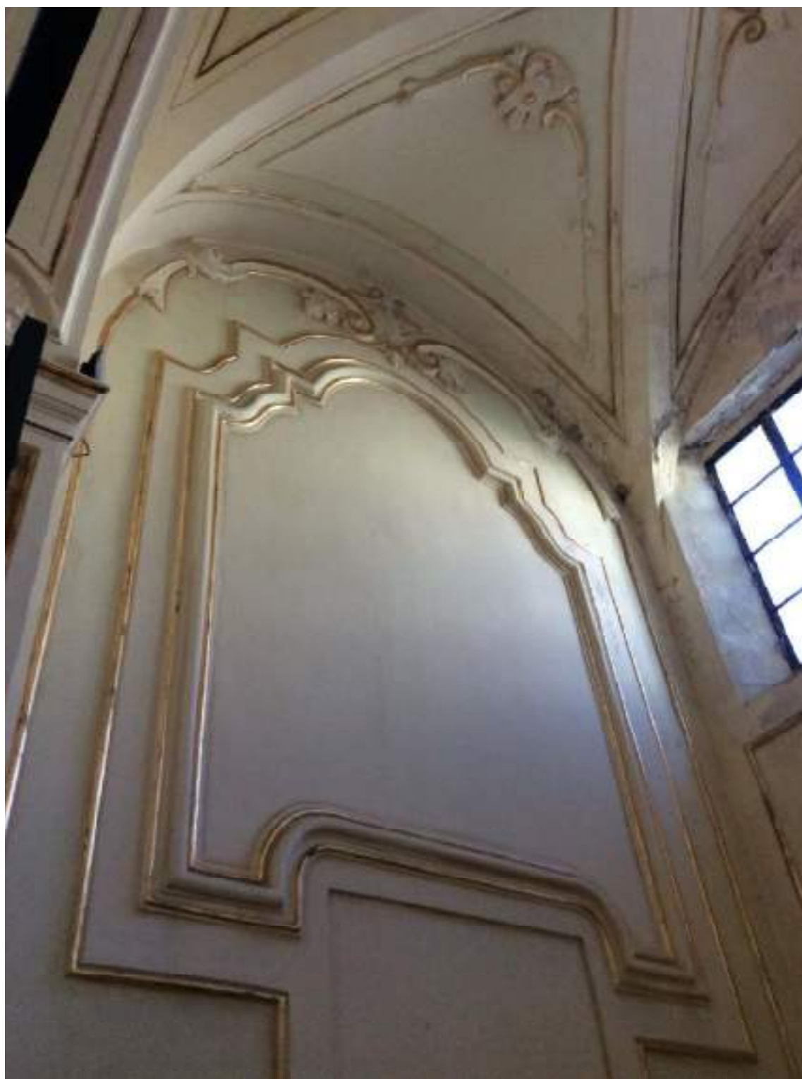
Figura 16. Degrado della parete sinistra pertinente alla cappella del Crocifisso
