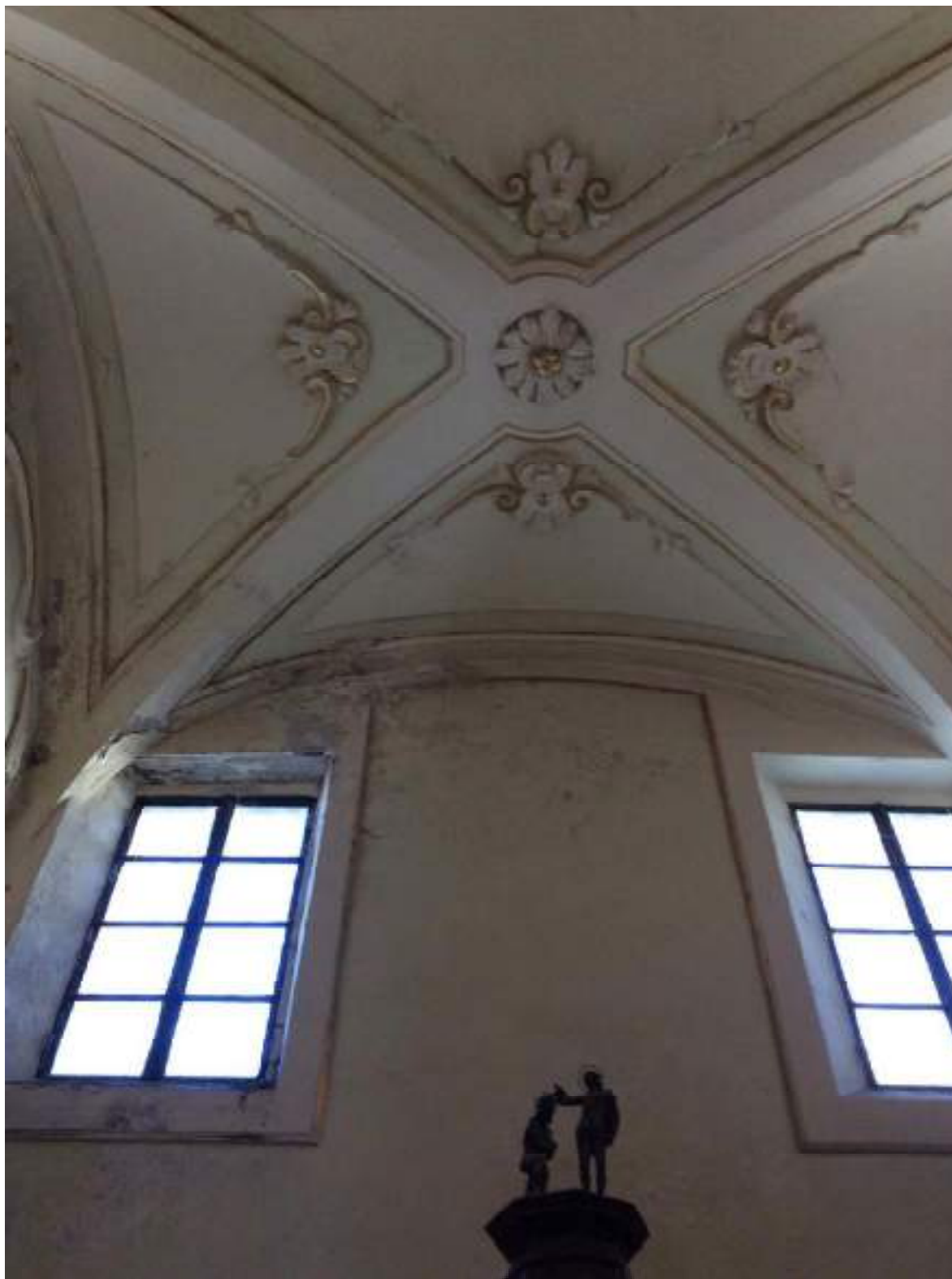
Figura 16 Cappella del fonte battesimale, degrado della volta e della parete di fondo
