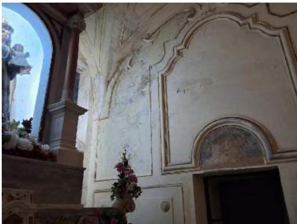
Figura 10 Degrado delle superfici murarie pertinenti alla cappella della Madonna del Monte Carmelo
