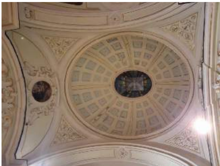
Figura 2 Cadute di intonaco e sollevamenti pertinenti all'intradosso della volta del presbiterio
