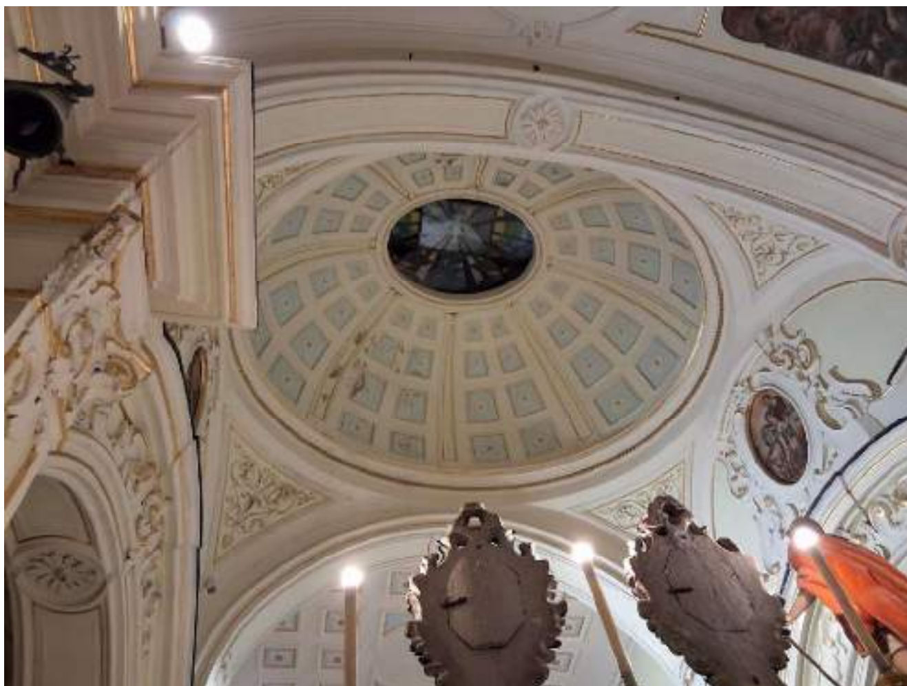
Figura 12 Cadute d'intonaco e distacchi pertinenti all'intradosso della cupola del presbiterio
