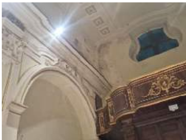
Figura 4 Degrado della porzione di muratura pertinente alla cantoria e all'aula liturgica
