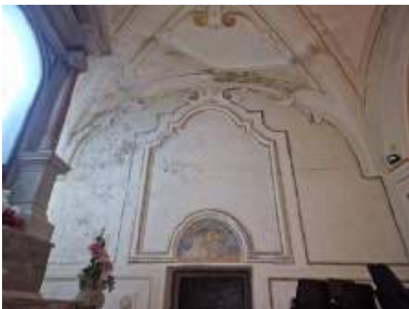
Figura 3 Degrado della muratura perimetrale della cappella della Madonna del Monte Carmelo
