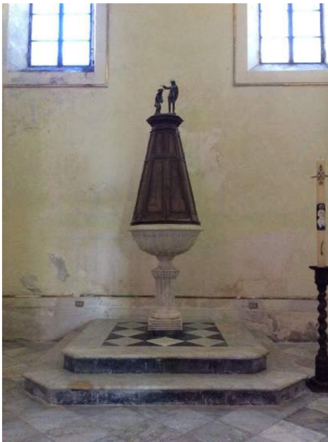
Figura 13 Cappella del fonte battesimale degrado della muratura di fondo
