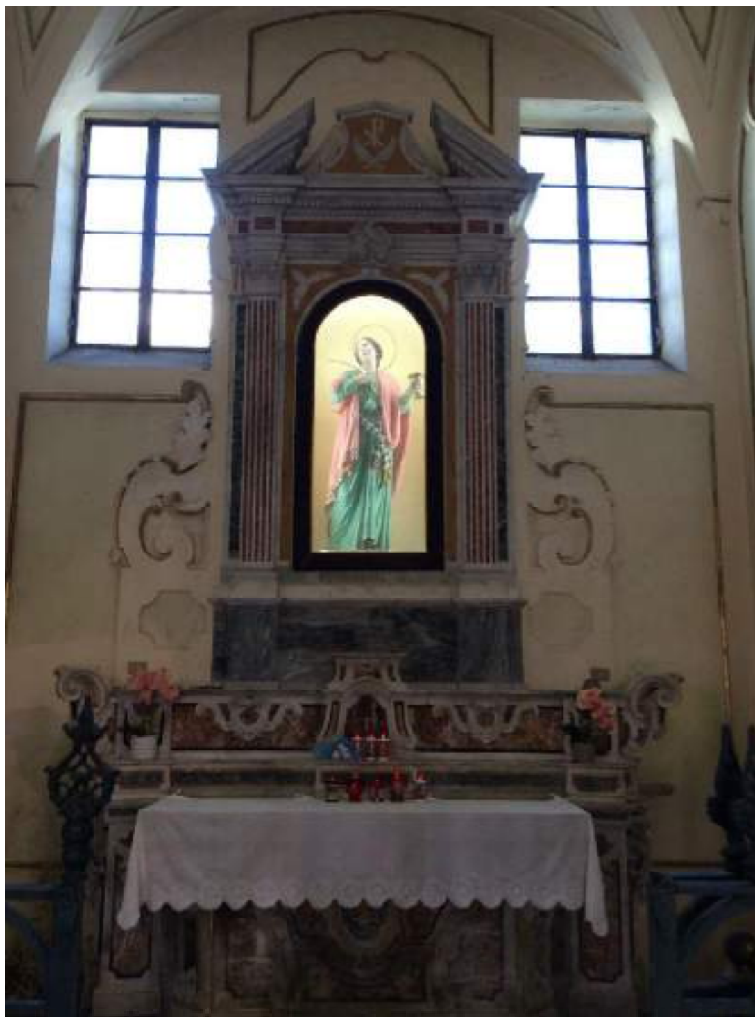
Figura 15 Cappella di Santa Lucia, degrado della muratura di fondo
