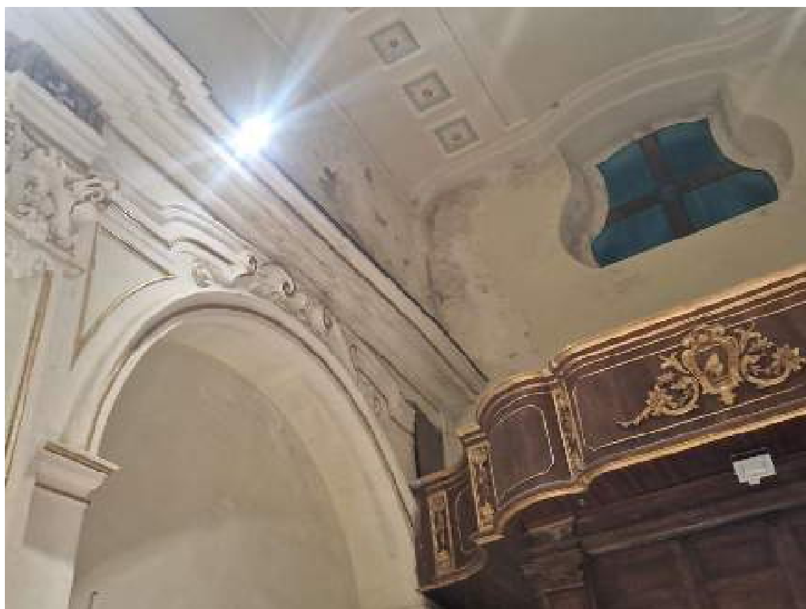
Figura 9 degrado la destro della cantoria
