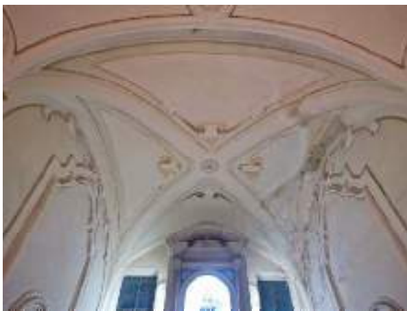
Figura 1 Degrado della volta della cappella pertinente alla Madonna del Monte Carmelo
