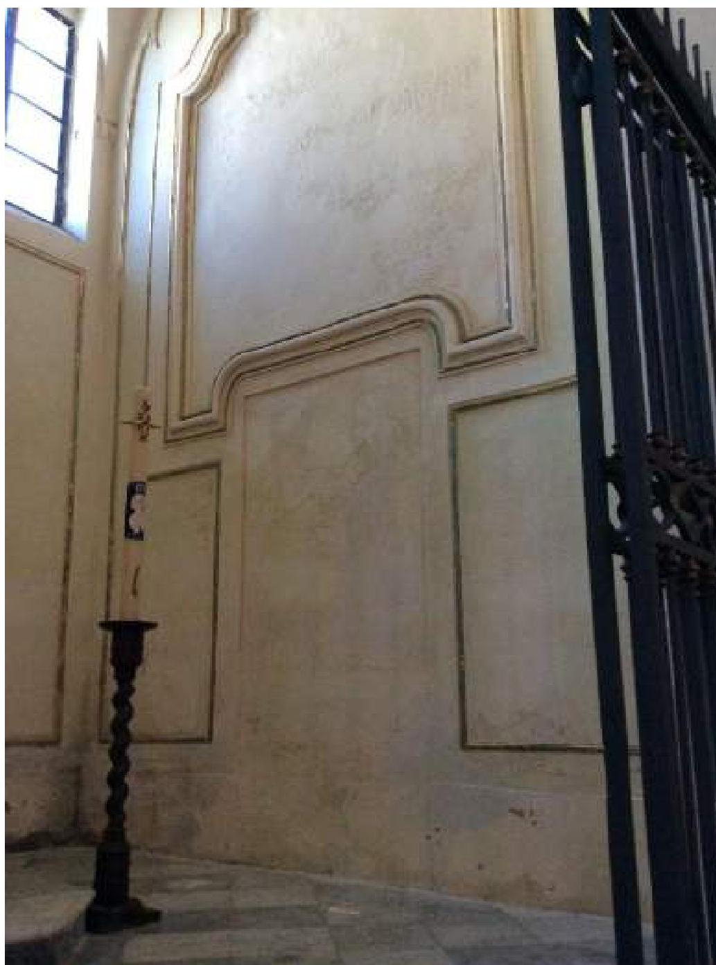
Figura 15 Degrado della parete destra pertinente alla cappella del Crocifisso
