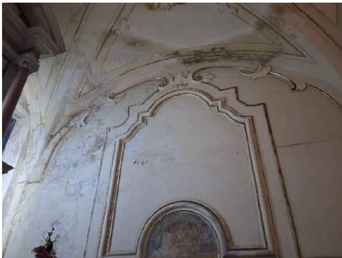
Figura 14 Degrado pertinente alla muratura laterale destra della cappella della Madonna del Monte Carmelo
